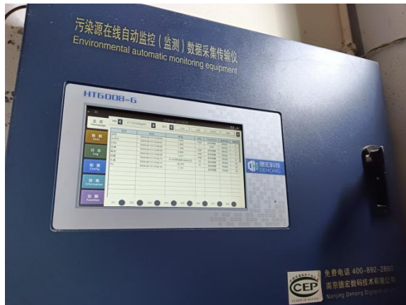
图 5 项目现场在线监控设备正常维护
