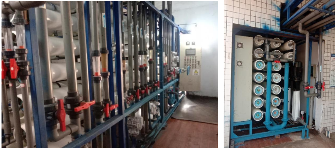
图 1 项目现场渗滤液处理设备现状图
