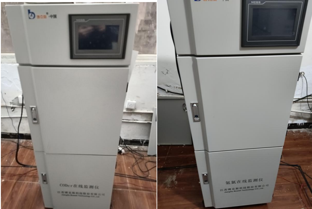
图3 项目现场在线监控设备现状图
