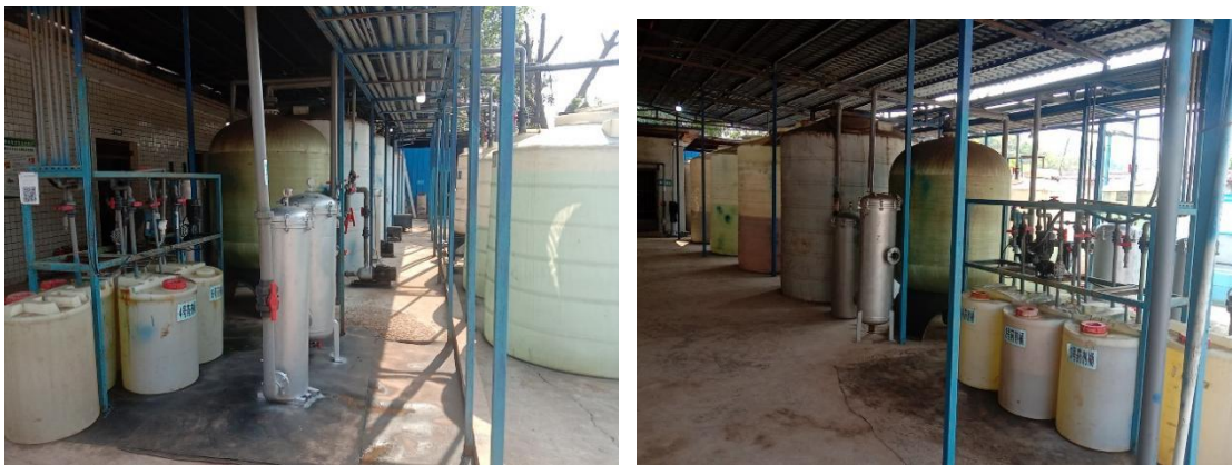
图 2 项目现场渗滤液处理设备现状图
